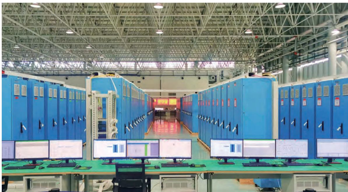
核电DCS设备
